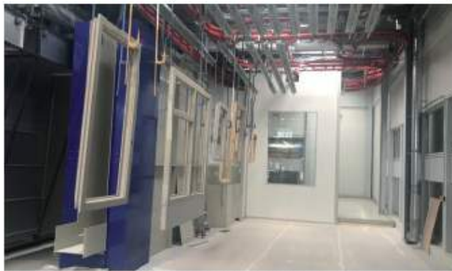
Die Teile hängen nicht immer ganz im Lot, wenn sie durch Scannerbereich und die Spritzkabine fahren. Dank 3D-Erkennung lackiert der Roboter stets parallel zur Oberfläche.
