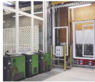
Nach dem parallelen Pufferbereich fahren die Rahmen an den Traversen hängend in den Lackierbereich.
