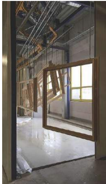
! Die neue Fördertechnik mit automatischer Traversenschrägstellung verbessert das Ablaufverhalten.
