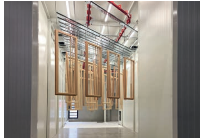
Für eine optimierte Aushärtung durch sanfte Trocknung sorgen in der Lackierstraße eine befeuchtete Abdunstzone und ein Decklacktrockner, in dem Luftfeuchtigkeit und Wärme reguliert sind. Quelle (zwei Fotos): Range + Heine
